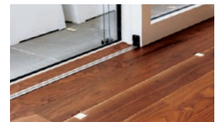
Laufschiene dezent im Fußboden eingelegt.
